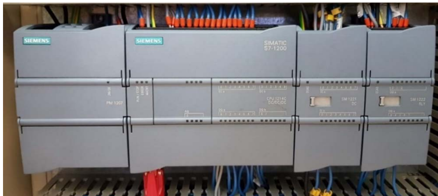
Egy S7 1200 PLC konfiguráció: tápegység, CPU 1214C DC/DC/DC, digitális be- és kimeneti bővítő modulok
