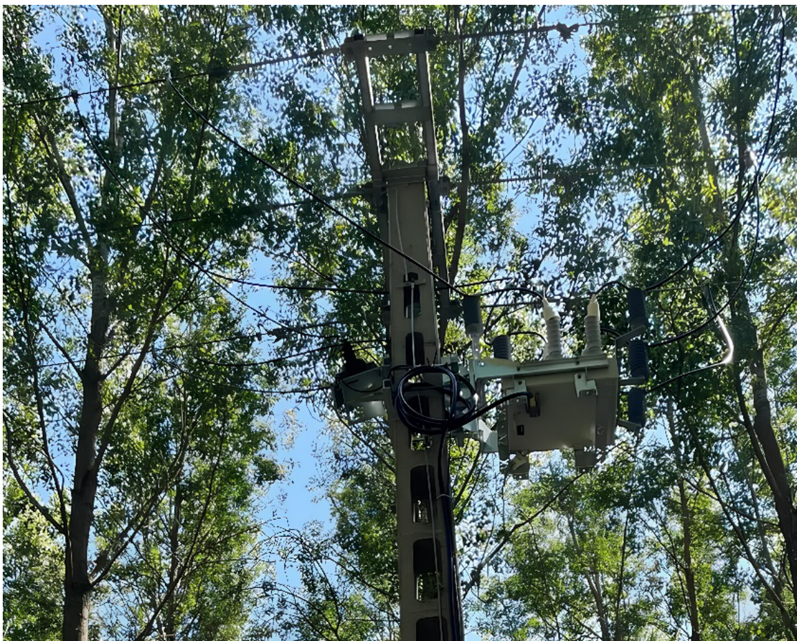
Egy 22 kV-os hálózaton felszerelt recloser
