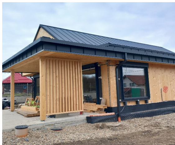
1. ábra. A vizsgált CLT épület korai kivitelezési fázisban, párazáró réteg, szélzárás és hőszigetelés nélkül (Fotó: Kádár Ferenc)
