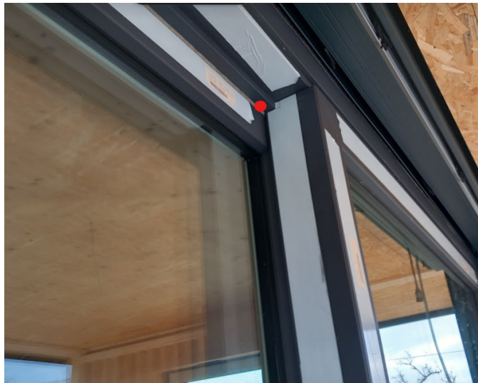
7. ábra. Légszivárgás a toloajtónál (Fotó: Kádár Ferenc)
