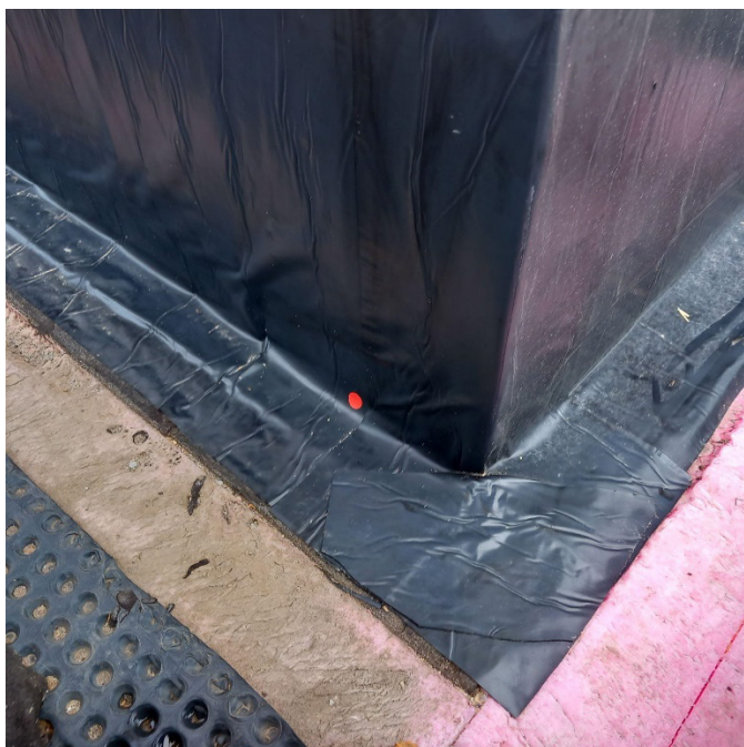
10. ábra. Légszivárgás a külső sarok és a vasbeton lemez csatlakozásánál (Fotó: Kádár Ferenc)
