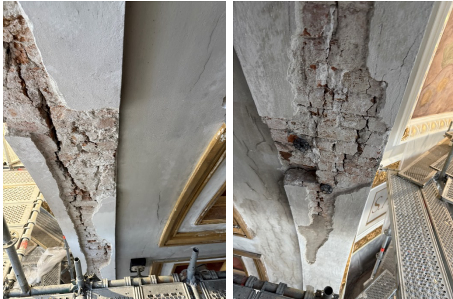
5., 6. kép. A vakolat eltávolításával látható jellemző repedések a szerkezeten
