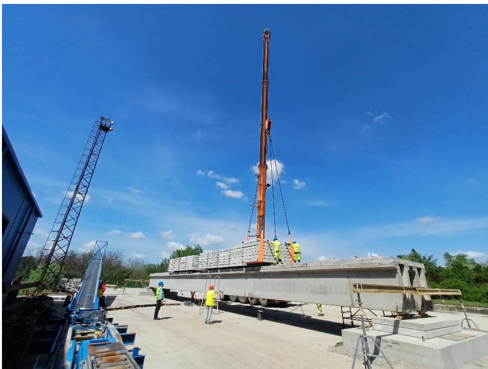
5. ábra. A hídgerendák próbaterhelése
