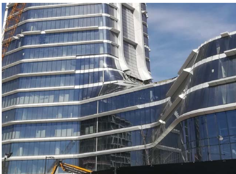
13. ábra. Torony és a pódium közötti homlokzati dilatáció
