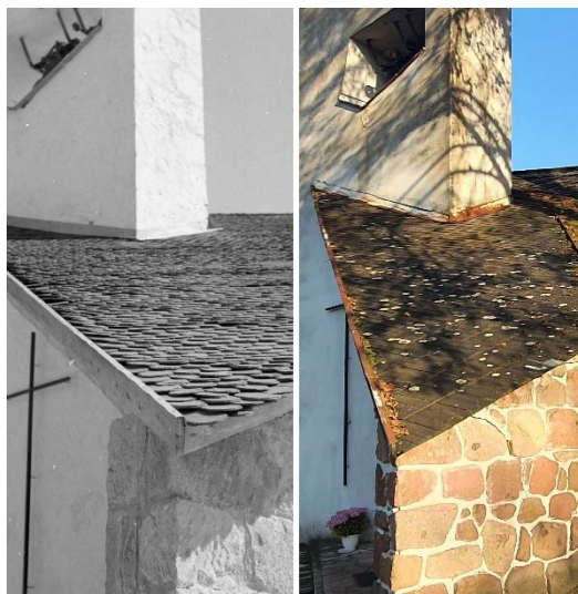
2. ábra. A héjazat eredeti és jelenlegi fektetési képe. Fotók: Csaba L. (bal), a szerzők (jobb)
