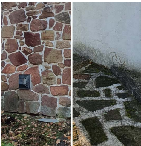
6. ábra. Homlokzati falak lábazati vizesedése
