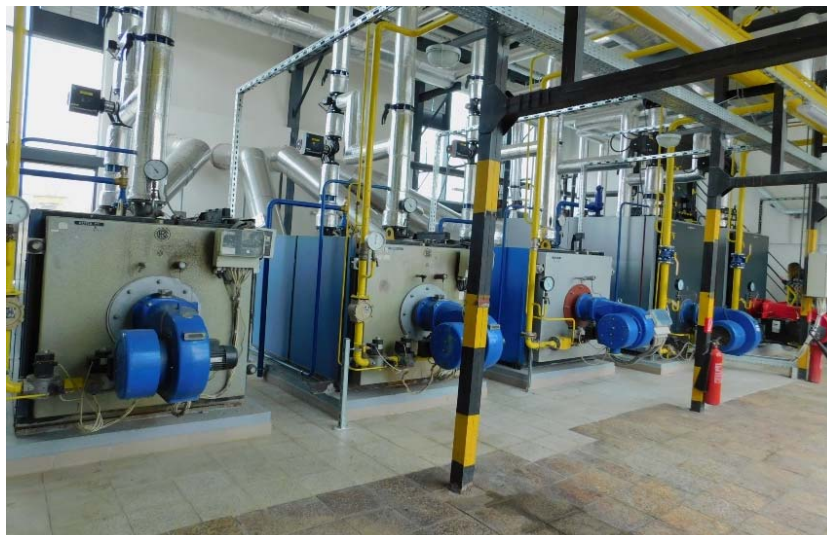
3. Ábra A Nagymegyéri csúcs-hőforrás a meleg vizes kazánok földgázzal működve
