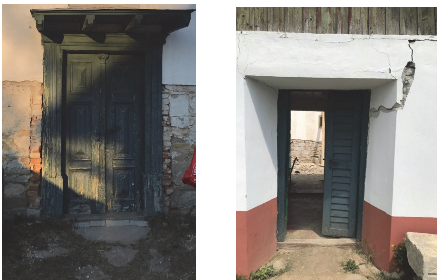
2. ábra. Eredeti nyílászárók, helyreállítás előtt
