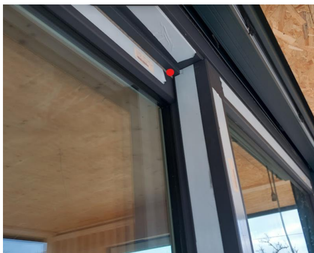
14. ábra Levegőszivárgás a tolóajtónál
