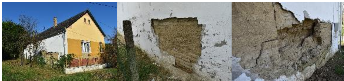
6. ábra. Értény, bal: legkitettebb fal és utcai homlokzat 2024., közép: sérült szakasz 2021., jobb: sérült szakasz 2024. (a szerző fotói)
