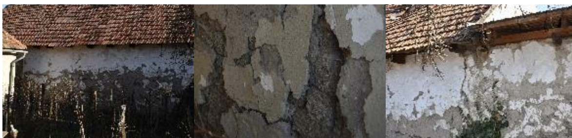
8. ábra. Domoszló északi fal (bal), erodált vályogtégla felületek (közép), tető síkváltás alatti lemosódás (jobb) (Naturarch Studio fotói)
